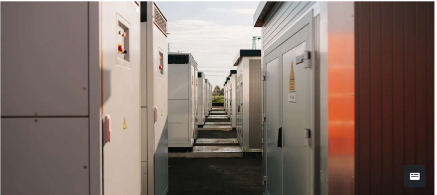
Großbatterien in Reih und Glied: Das Stromnetz gerät durch die Energiewende zunehmend an seine Grenzen.
